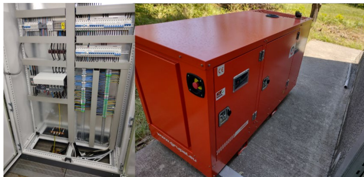
Фигура 5: Компоненти от новоизградената система за резервно електрозахранване.
